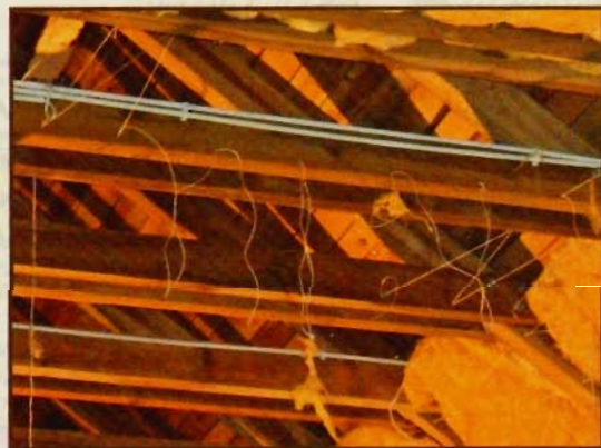
Zniszczenia po moim przelocie
